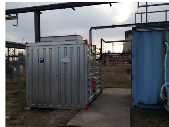
Abluftreinigung Schwarze Pumpe
